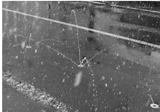
消雪パイプ(長岡市)
