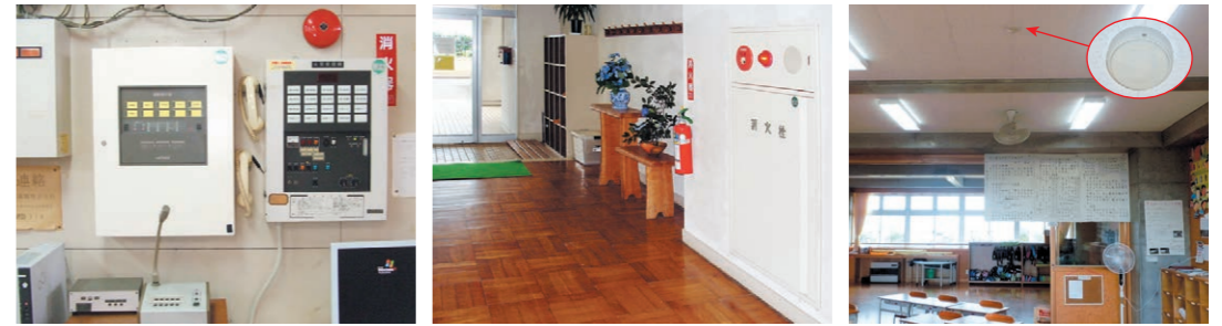
火災報知機(受信機)
