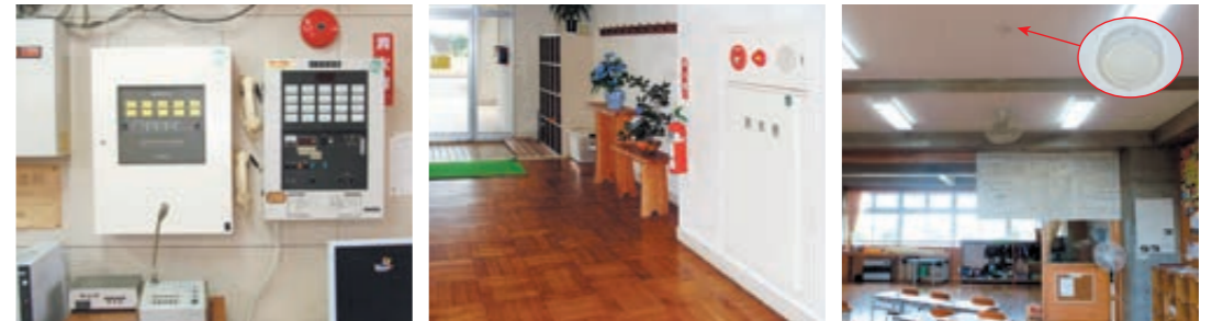
火災報知機(受信機)
