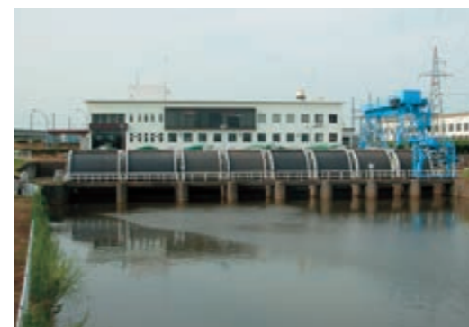
①刈谷田川右岸排水機場（今井）
