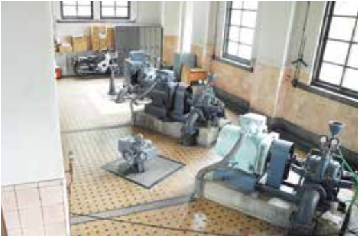
送水ポンプ室
