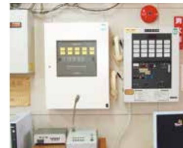
火災報知機 (受信機)
