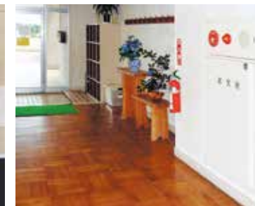
消火器・火災報知器 (発信器)・屋内消火栓
