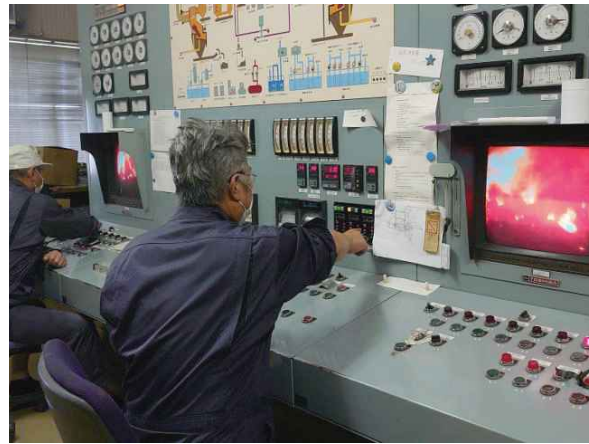
制御室の様子
